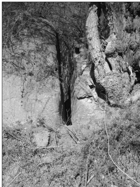
Figura 7. Apertura sobre el cerro para el pasaje de agua. Conformar el Sector 4 de nuestro esquema.
